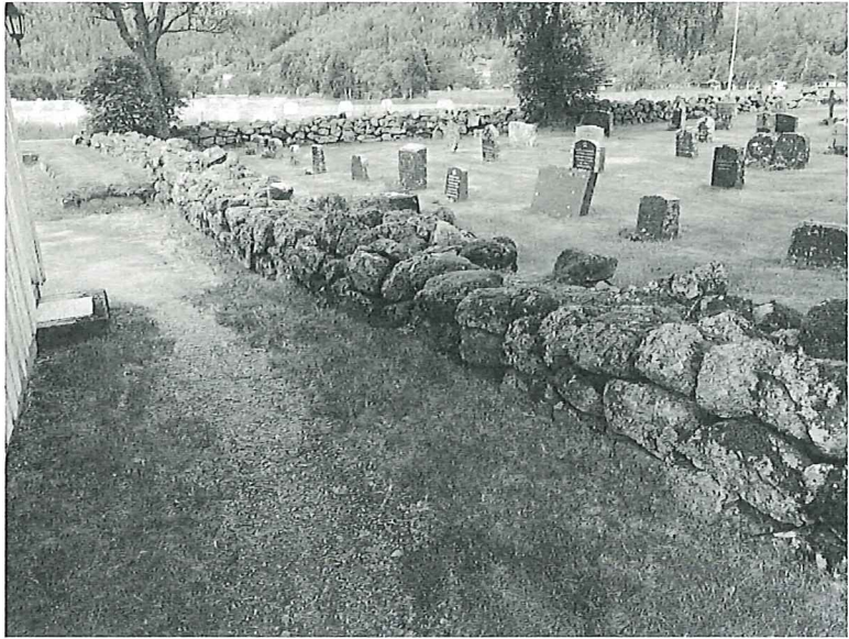
ved b rehus, manglande midtfyll, om lag 25m oppretting
